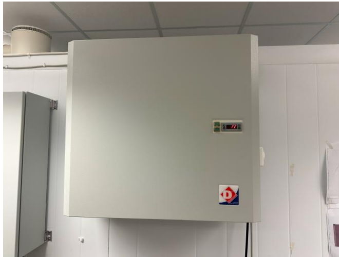
Fig. 4.3: Kjøleanlegg utenfor boksen
