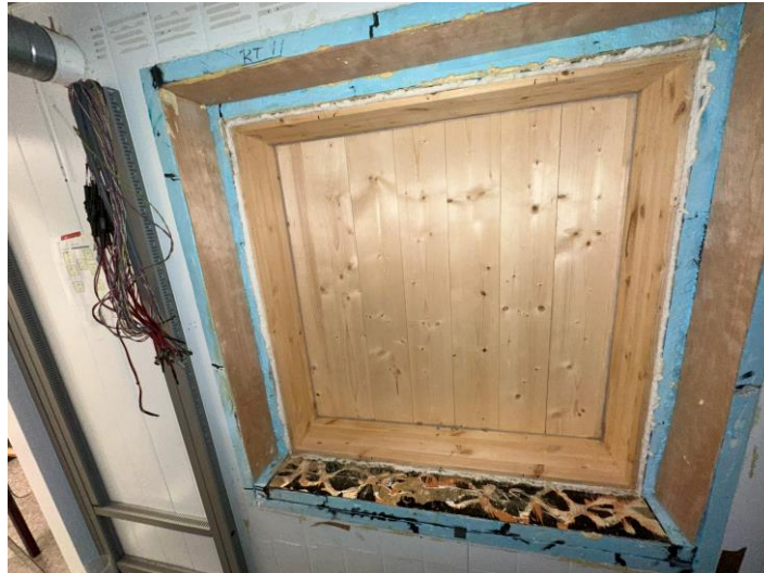
Fig. 4.9: Grunnkasse plassert i hotbox
